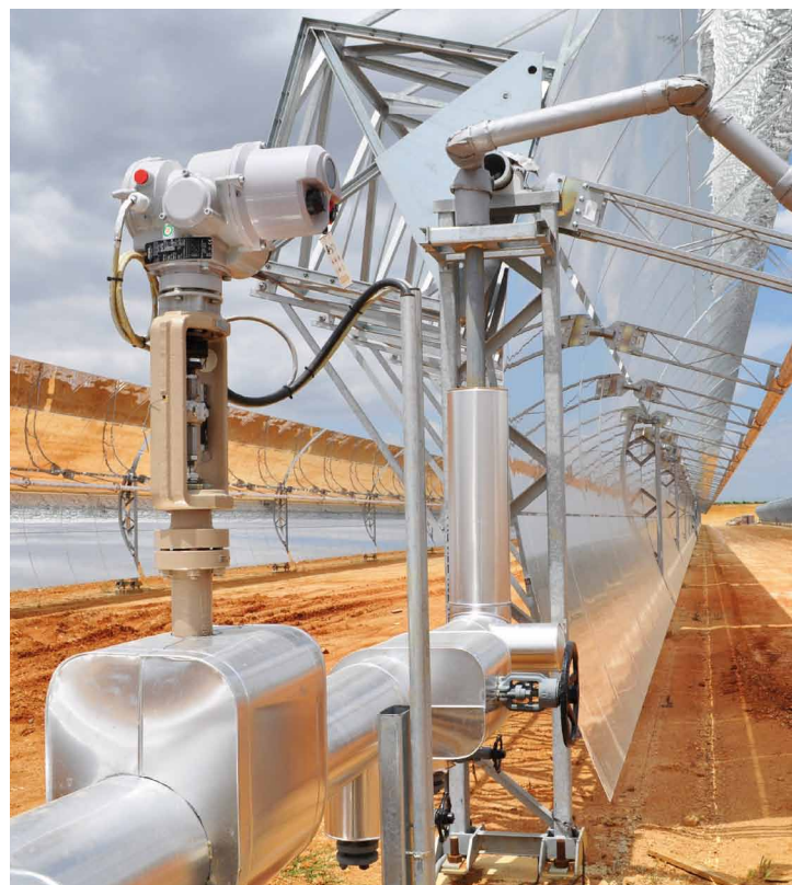
Los colectores cilíndricos calientan el aceite térmico a temperaturas de hasta 400 °C. 168 válvulas Tipo 3251, NPS 3, Class 600 con fuelle y accionamiento eléctrico, se ocupan de regular el caudal óptimo.
