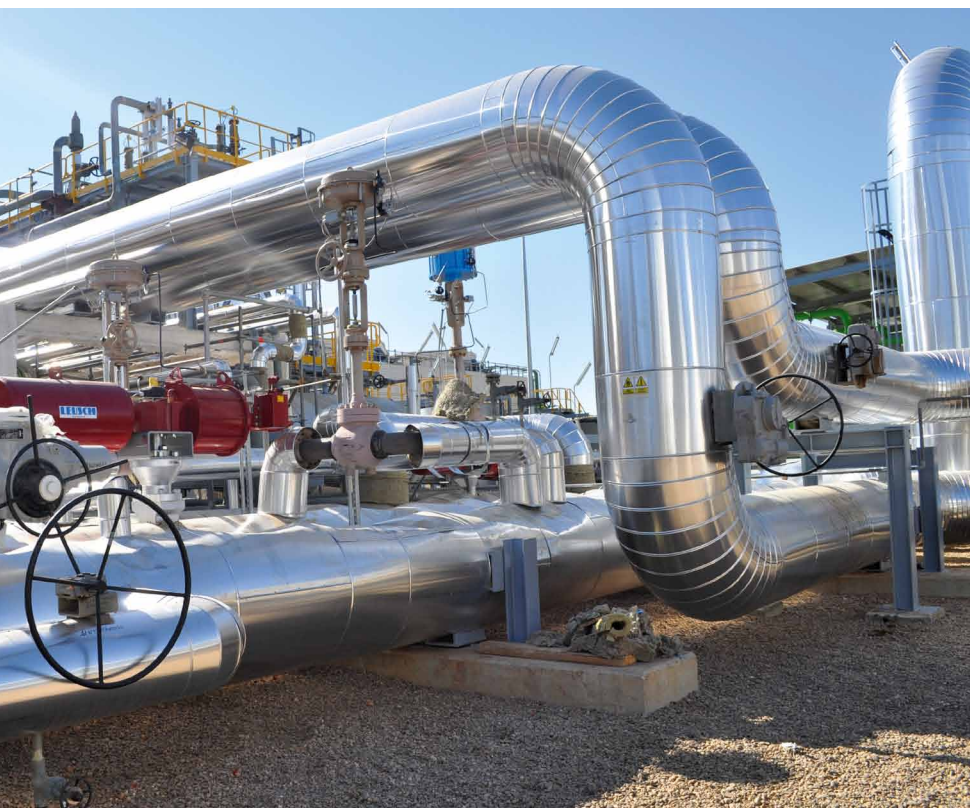
En la planta Samcasol una válvula de mariposa Leusch LTR 43 y una válvula de globo SAMSON Tipo 3241 funcionando en split-range se encargan de controlar el caudal y la temperatura del aceite térmico que circula por todo el campo solar hasta la central eléctrica.
